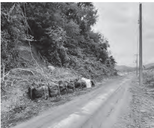
通学路土砂崩れ仮復旧後
