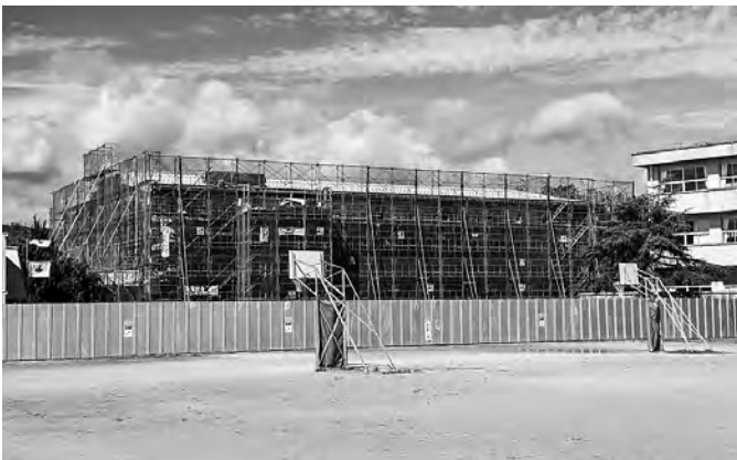
先に改修工事が進む中郷第一小学校屋内運動場 (10月撮影)
