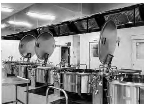
複合防災・学校給食センター内煮炊き調理室の大型蒸気釜（磯原町・2021年7月）
