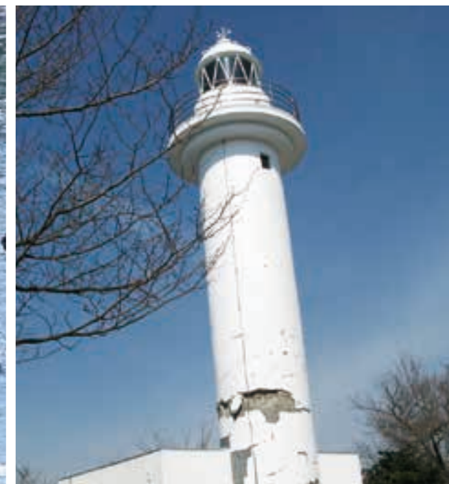
折れて使用不能となった大津の灯台
