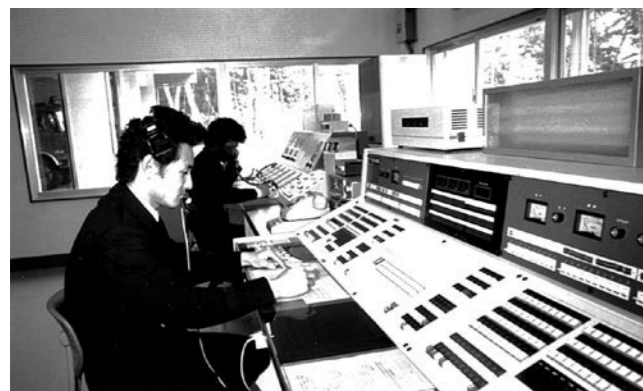
消防救急緊急指令装置が消防本部に導入された (昭和57年)
