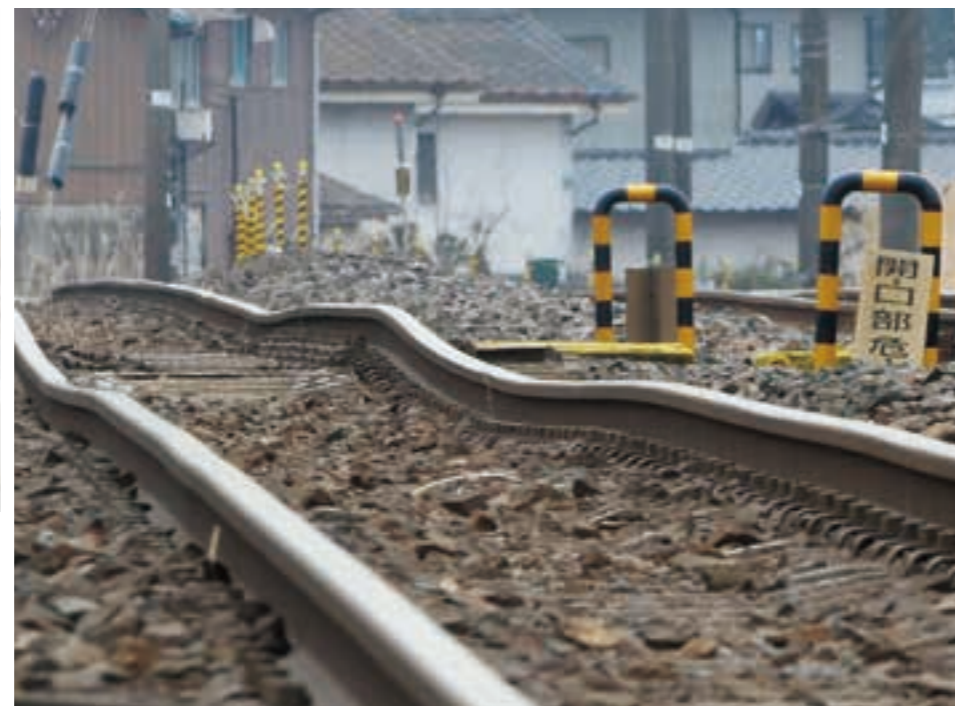
地震でゆがんだJR常磐線の線路
